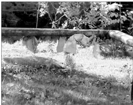
Тепло поступает в доме через «голые» трубы.
